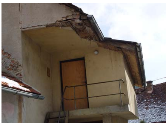
5. Objekt »izdaja« njegova starost in dotrajanost, zato je potreben tudi zunanje prenove.
