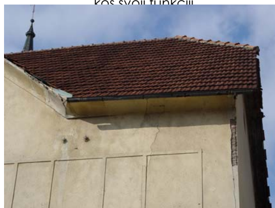
4. Odpadanje ometa je vidno na glavni fasadi in zaradi tega je vidna tudi delna sestava sten (trstika).
