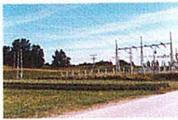
transformatorska postaja – svbnik
