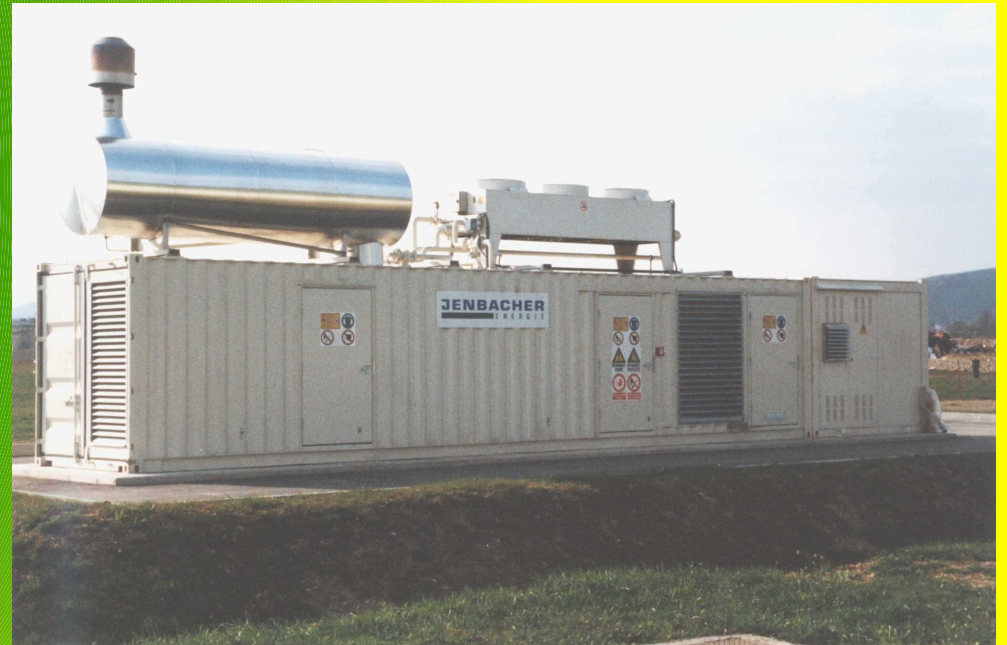
mala plinska elektrarna (vir: Snaga d.o.o.)
