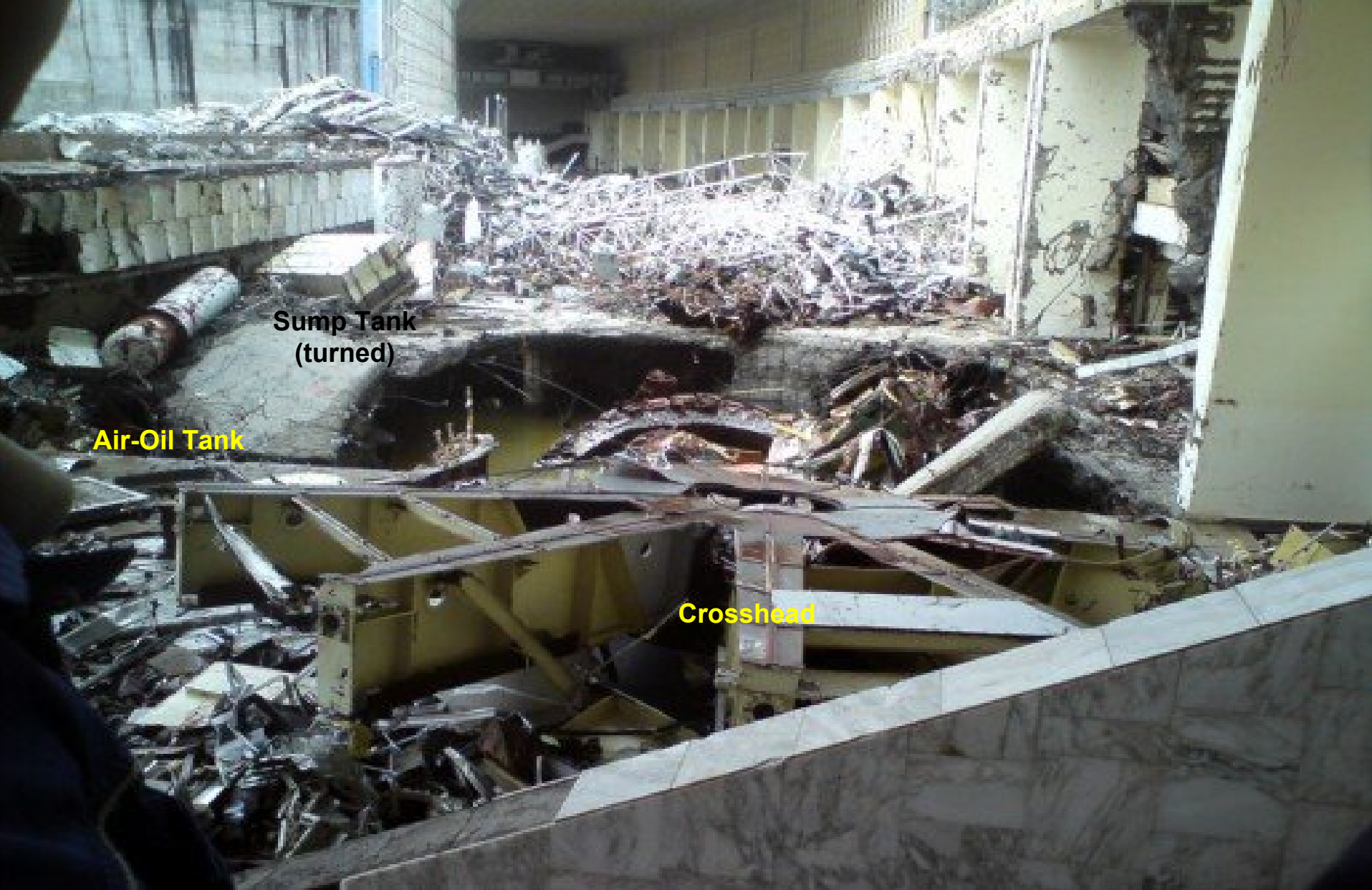
Nesreča, 75 mrtvih, najverjetneje posledica utrujanja materiala zaradi vibracij. (elektrarna je začela z obratovanjem 1978)
