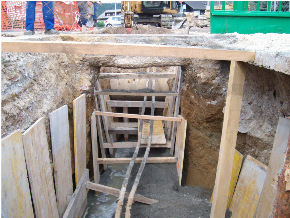
Slika 37. Varstvo pri delu – pomanjkljiva zaščita gradbene jame
