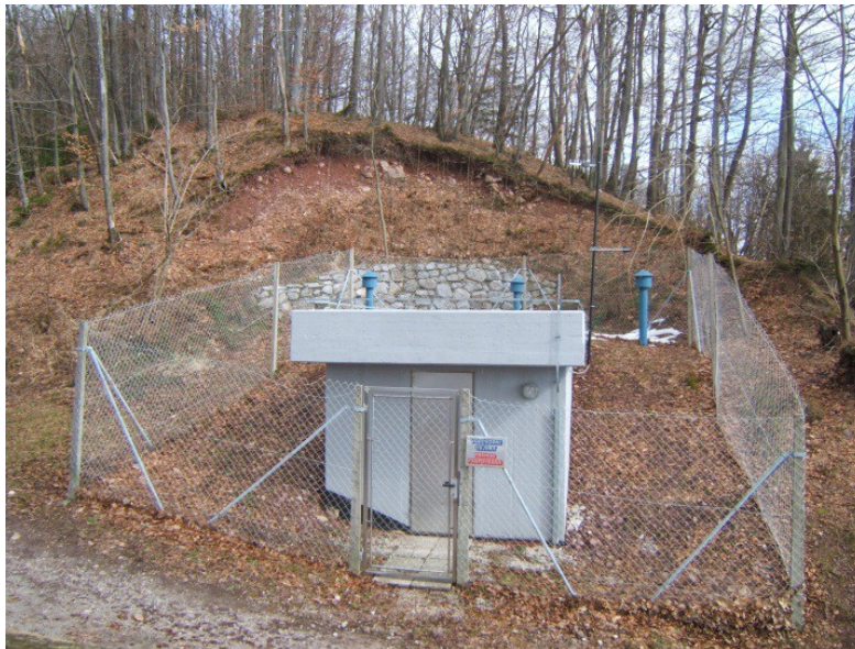
Slika 79: Manjši vkopan vodo hran (viden je vhod v armaturno celico in zračniki)
